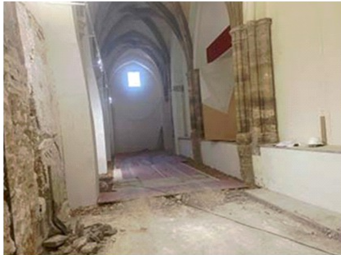
El Ayuntamiento de Calatayud elaboró un proyecto en el que se ponía de manifiesto la necesidad de intervenir en los revocos del interior del claustro
